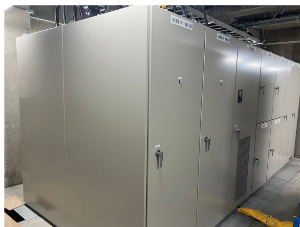
図4 高圧キュービクル
