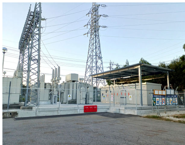
図2 66kV 特高受変電設備
