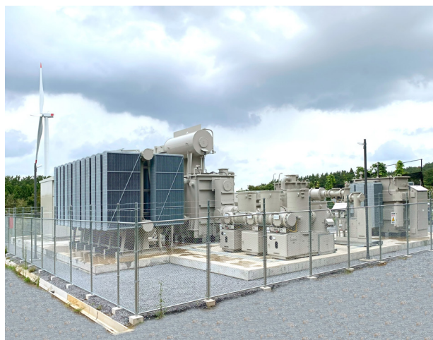
図1 66kV 特高連系受変電設備（プロジェクト変電所）
