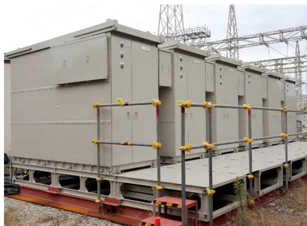
図2 22/33kV 移動用キュービクル
