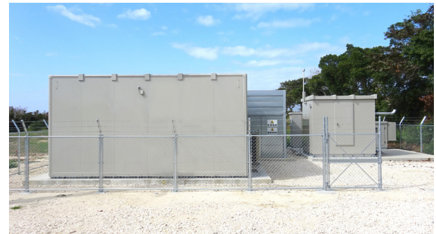
図4 来間島地域マイクログリッドシステム 【設備構成】高圧連系設備・蓄電池システム・EMS・補充充電用ディーゼル発電機
