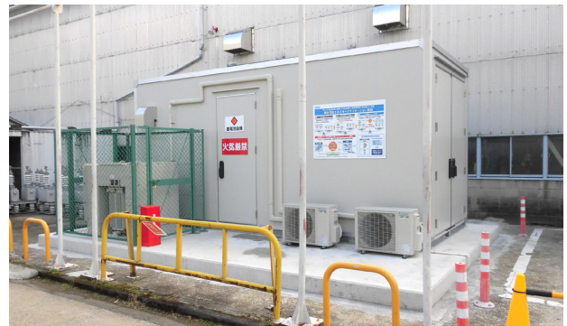
図6 蓄電池システム外観
