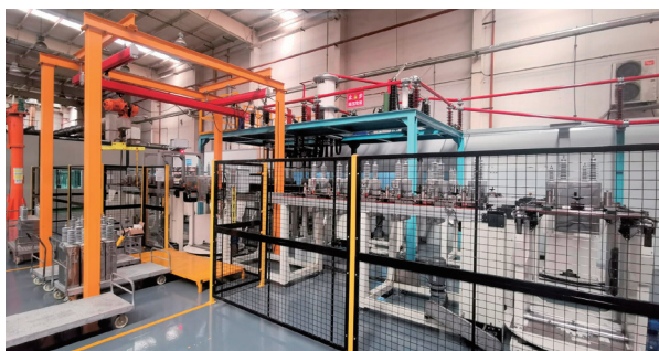
(b) 設備外観
