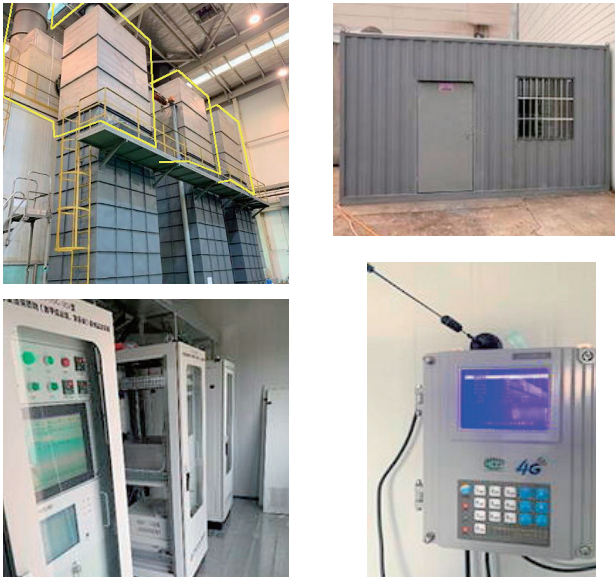
(a) 塗装ブース排気設備(3基) (b) VOC監視装置コンテナ (c) VOC監視装置(3台) (d) 4G携帯電話回線ルーター
