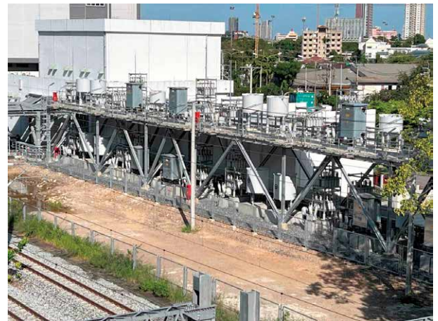
図1 高調波フィルタ設備
