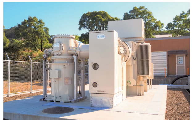
図1 66kV 特高連系変電設備
