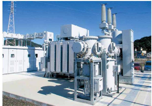
図4 66kV 特高受変電設備
