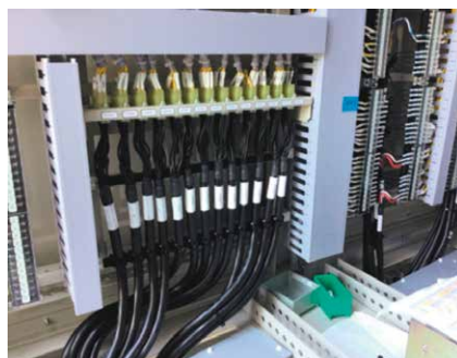
図20 コネクタケーブル適用の例 (特高監視盤側)
