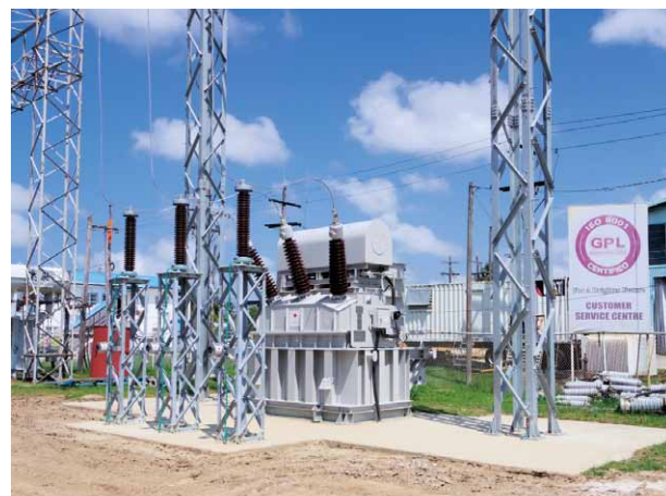
図3 69kV 大地置コンデンサ設備（Canefield変電所内）
