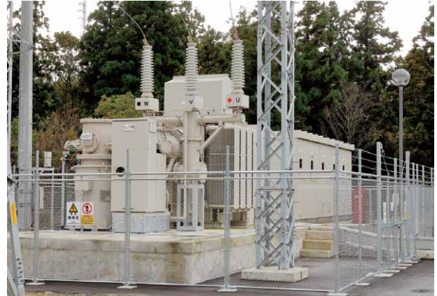
図3 66kV 特高連系受変電設備
