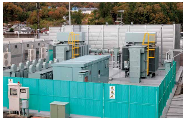
図4 77kV 特高受変電設備
