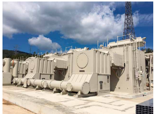
図2 分路リアクトル設備
