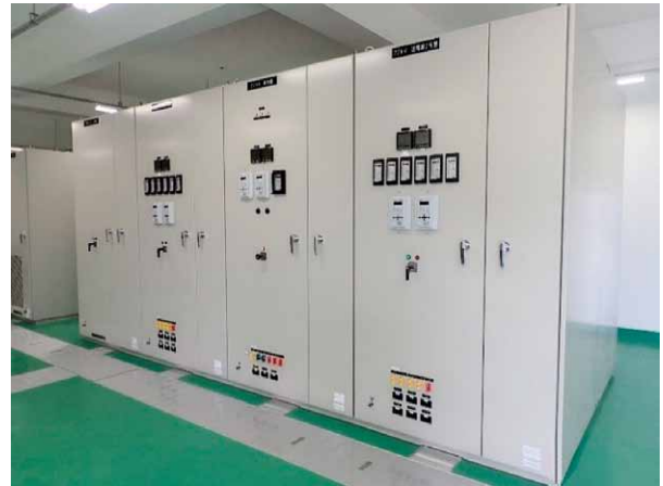
図6 24kV 閉鎖配電盤
