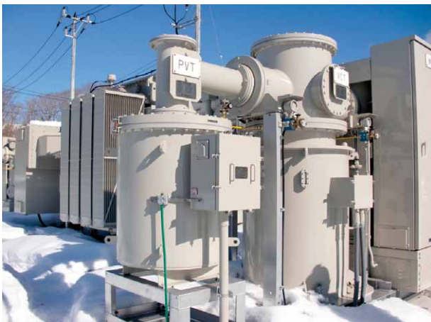
図4 66kV 25kVA PVT
