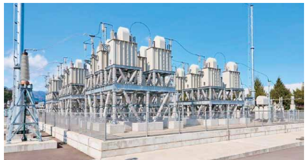
図1 高調波フィルタ設備(交流フィルタ設備)
