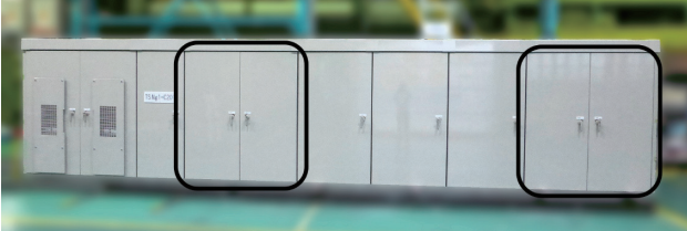
図5 変電塔正面（枠内が受電盤）
