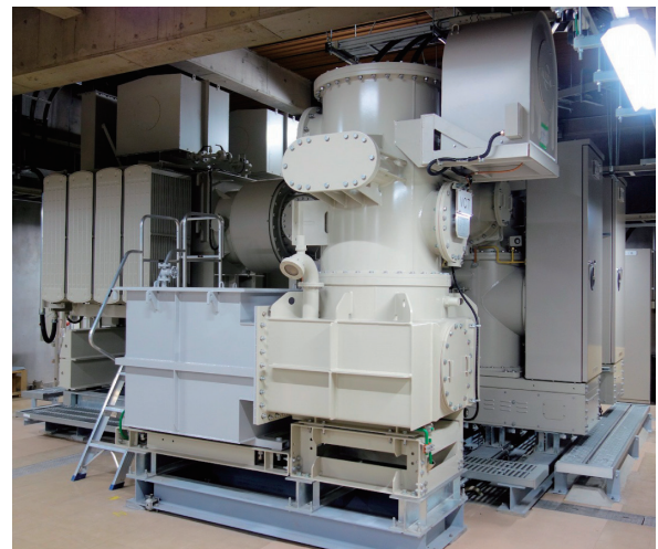
図1 66kV 受変電設備
