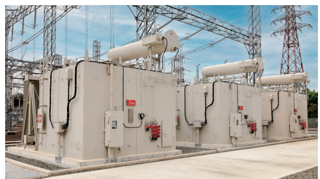
図1 分路リアクトル (77kV 30 - 60Mvar 50dB)
