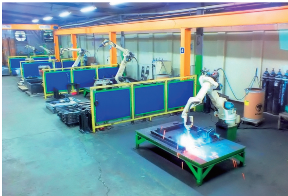
図3 NET溶接ロボットライン
