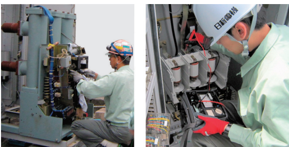
図1 点検業務（左：機器点検、右：配電盤の点検）
