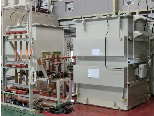
図3 大電流変圧器外観
