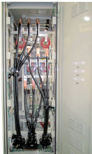
(配電線盤3段積)
