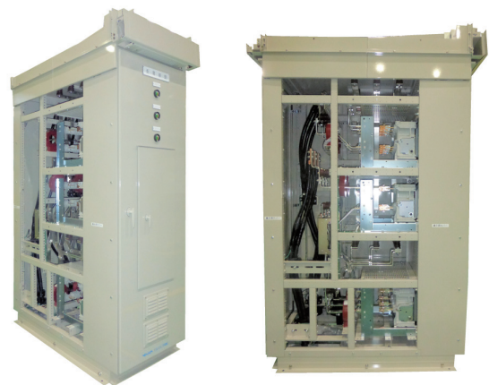
(配電線盤3段積)
