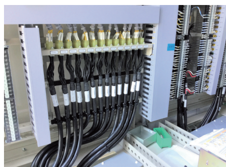
図28 コネクタケーブル適用の例 特高監視盤側
