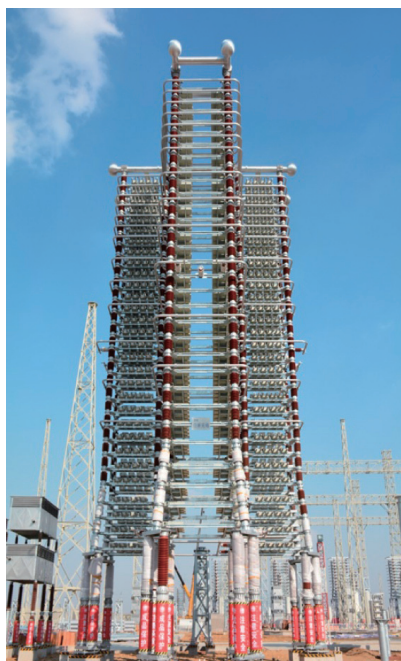
図1 ±800kV 直流フィルタコンデンサラック (高さ26m)
