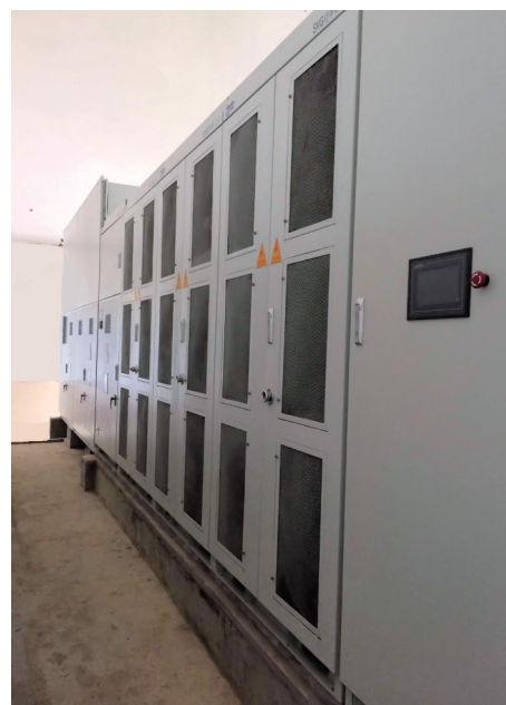
図1 製品納入状況(電気室設置状況)
