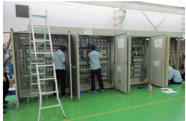
図5 動力盤・制御盤生産状況
