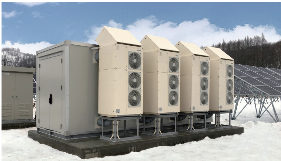
図4 ハイブリッド温度制御方式エンクロージャ設置状況
