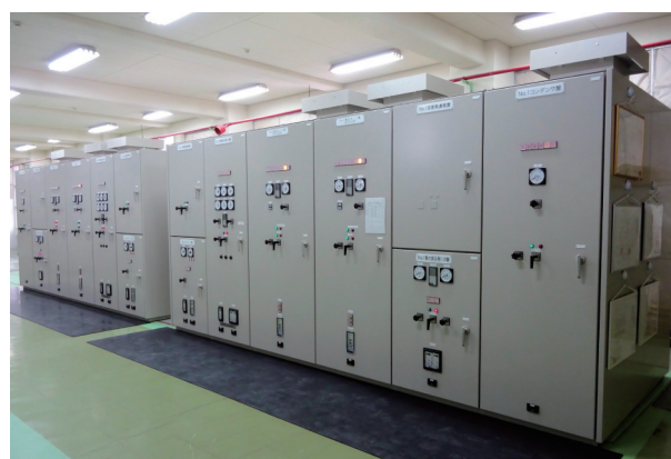
図5 増圧ポンプ盤
