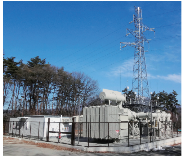
図1 154kV受変電設備
