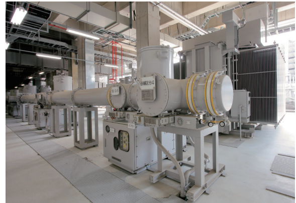
図2 66kV受変電設備
