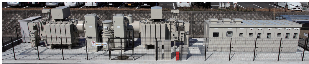
図3 77kV受変電設備
