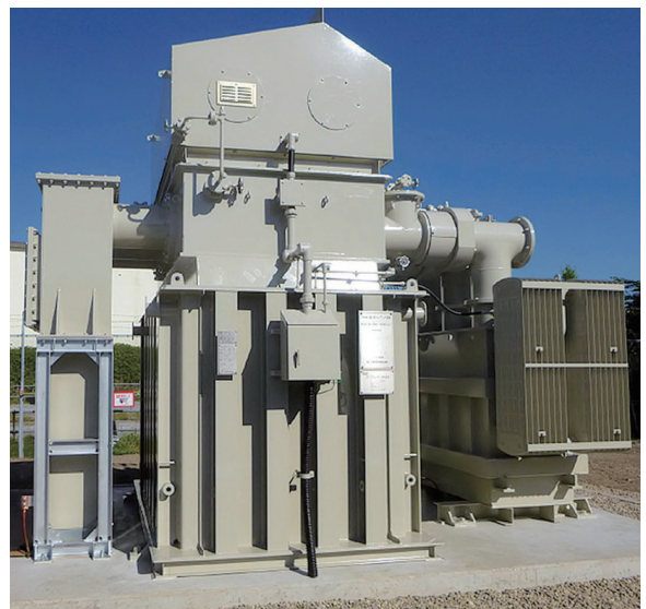
図1 66kV大地置コンデンサ設備
