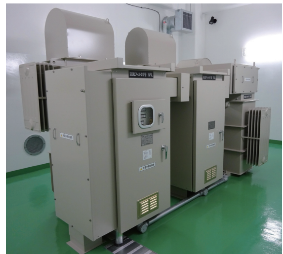
図3 交流フィルタ設備
