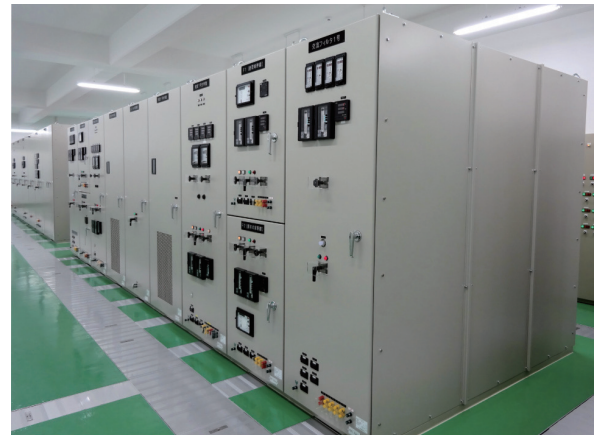
図2 24kV・7.2kVメタルクラッド
