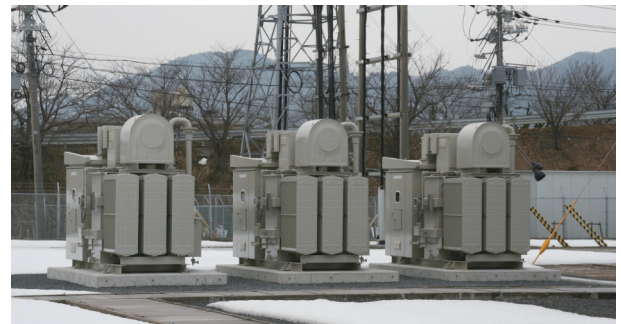
図8 高压級SHR (6.6kV 1.5Mvar 真空遮断器盤付属) [中国電力株式会社 境港変電所]
