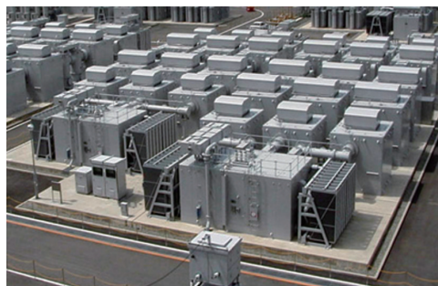
図10 直流連系用交流フィルタ用直列リアクトル（大地置形AC500kV設備）
