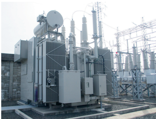
図16 変圧器（107.5/6.9/23kV 30/25/10MVA 50dB OLTC付）
