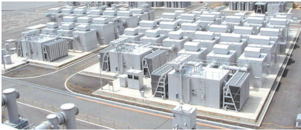
図15 大地置式 AC500kV 高調波フィルタ設備
