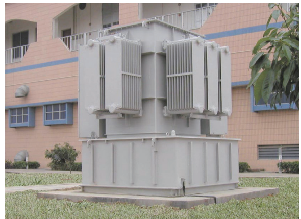
図7 中国生産タンク形第1号製品(ユニット形11kV 6Mvar)
