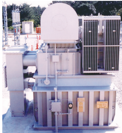
図13 特別高圧回路用ユニット形コンデンサ設備 (66kV 10Mvar)
