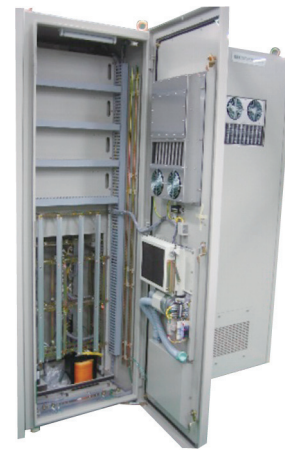
図32 腐食性ガス対策装置
