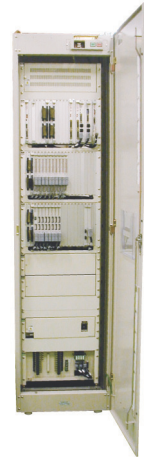
図18 インテリジェント遠制装置
