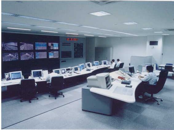
図23 クライアントサーバ方式大規模広域施設制御システム「HIWAYMATE」
