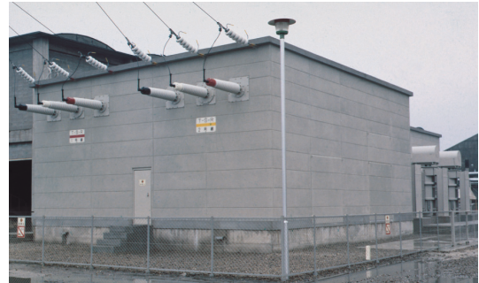
図 3.2.11 66/77kVALC製閉鎖形配電盤 130②
