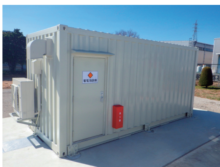
図 4.2.3 電池電力貯蔵システム
