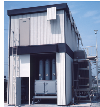
図 3.2.4 77kVパッケージサブ
