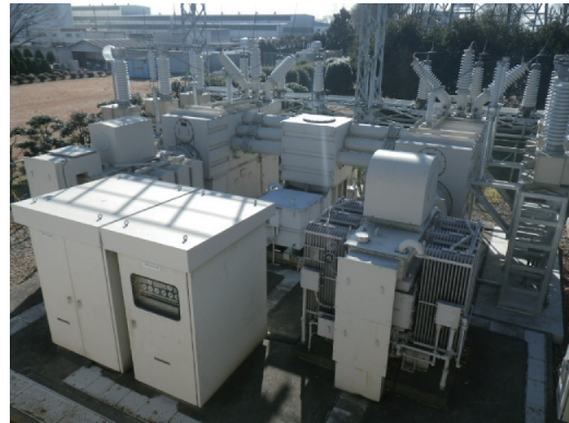
図 4.2.4 前橋製作所の66kV特高受変電設備
