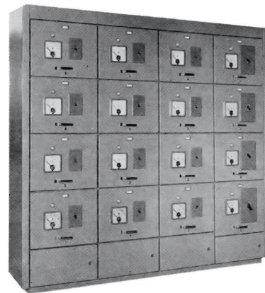
図 3.1.10 コントロールセンタ
