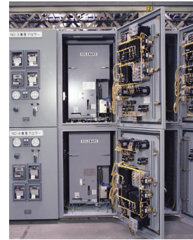
図 3.3.6 MBB収納6kVスイッチギヤ PU499①
