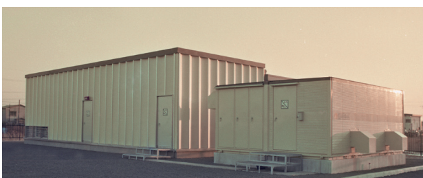
図 3.3.2 寒冷・積雪地域用66kVパッケージサブ 56192
