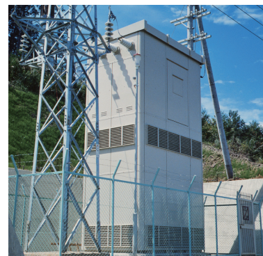
図 3.2.5 33kVパッケージサブ (2階建方式)
