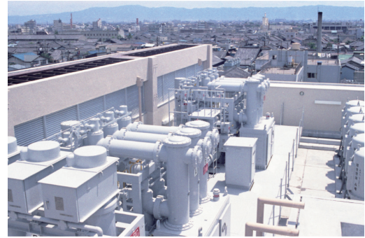
図 3.2.3 相分離形ガス絶縁開閉装置
