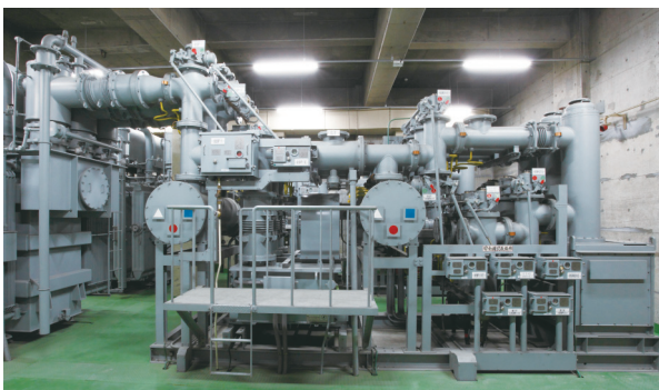
図 3.3.17 66kV GIS 自家用1号機
