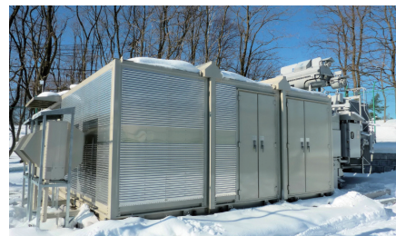
図 3.4.6 寒冷地向け33kV配電塔
