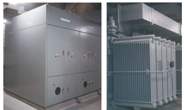
図 3.2.17 EXPO '70 政府館受配電設備
