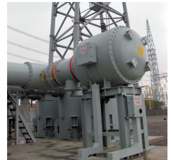
図7 超高压ガスVT（ガス計器用変圧器）
