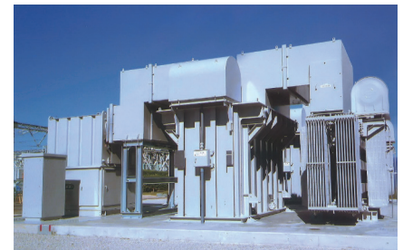
図5 縮小型電力用オールフィルムコンデンサ設備
