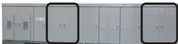
図1 変電塔正面（枠内が受電盤）
