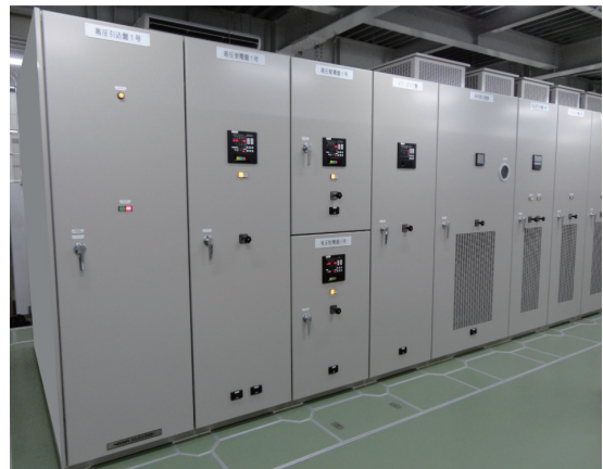
図1 7.2kV配電所設備
