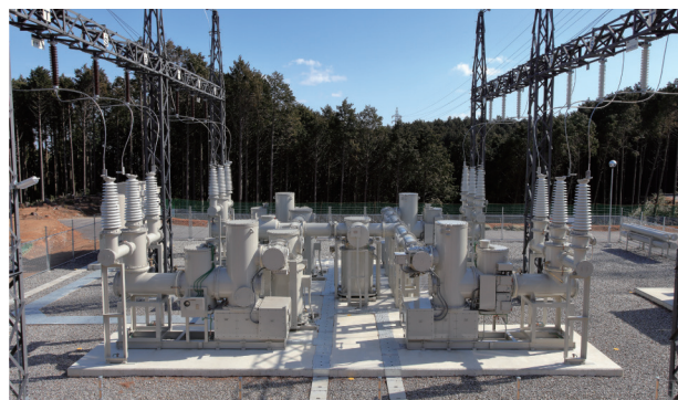
図3 77kV開閉所設備
