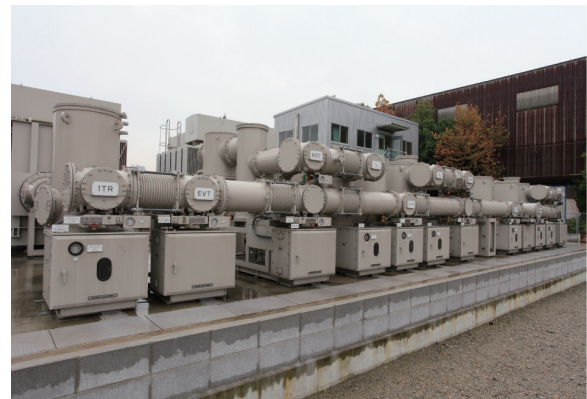
図1 77kV受電設備
