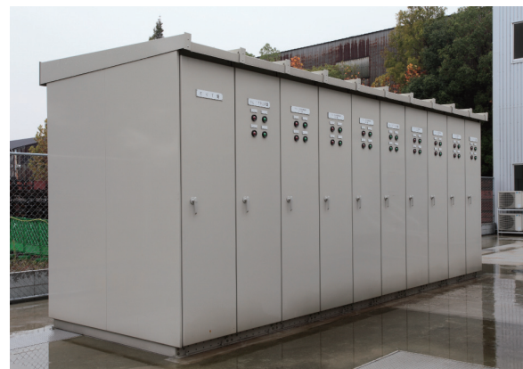
図2 22kV配電設備
