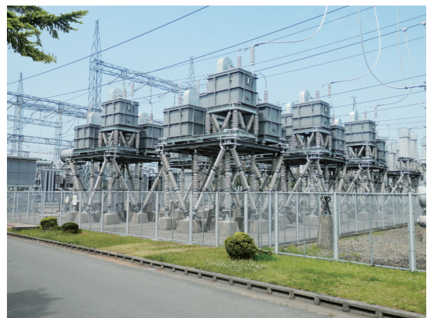
図1 第5分路フィルタ設備
