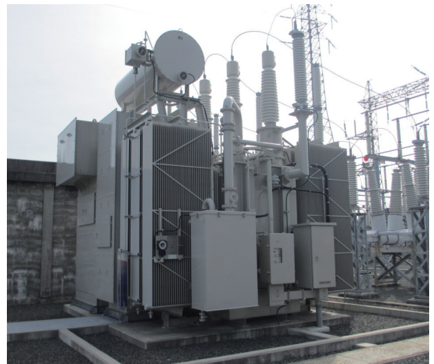
図3 配電用変圧器 (変圧器 107.5/6.9/23kV 30/25/10MVA 50dB)
