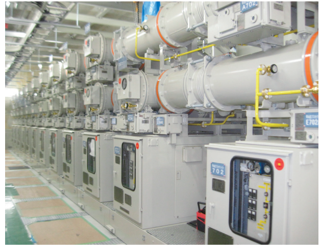
図2 牛島町変電所納入 84kV縮小形GIS
