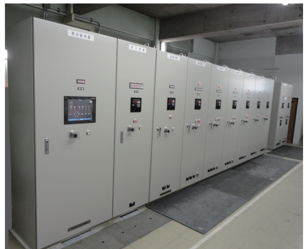
図1 7.2kV高圧配電設備
