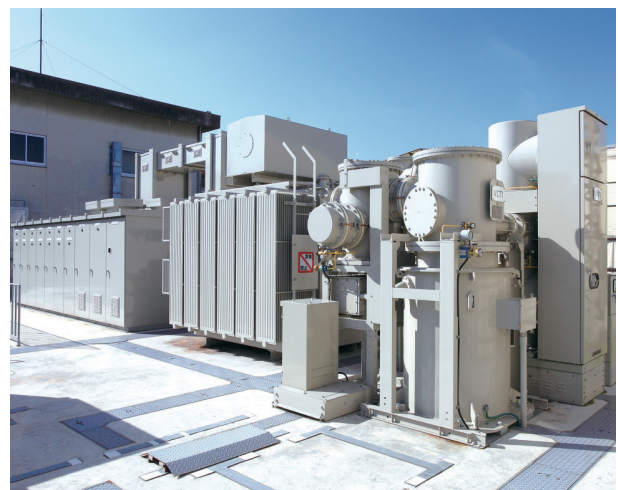
図4 77kV受変電設備
