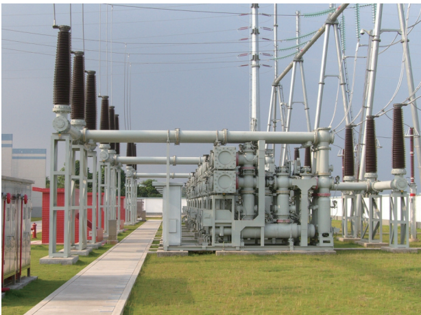
図6 220kV GIS 設置例
