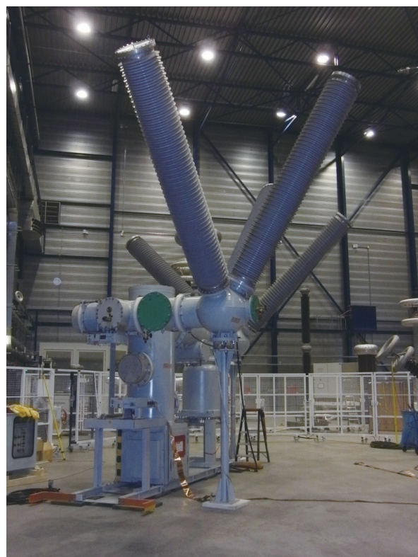
図4 145kV GIS絶縁試験（オランダ KEMA試験所）
