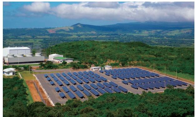
図1 1MW太陽光発電システム
