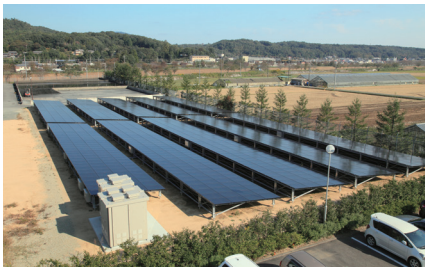
図1 地上部太陽電池設置状況
