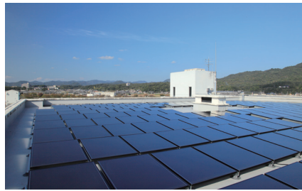
図2 管理棟上部太陽電池設置状況
