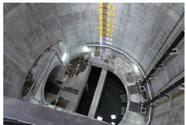
図6 雨水貯留管（乙訓ポンプ場）
