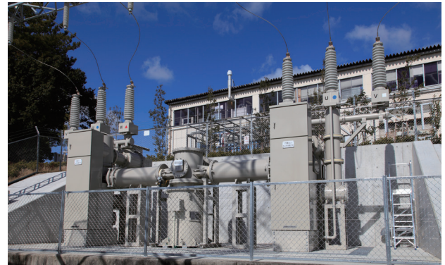
図5 77kV受電設備
