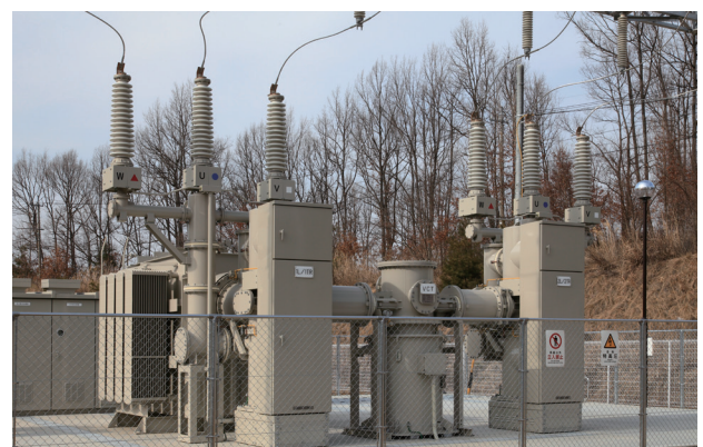
図6 77kV受変電設備
