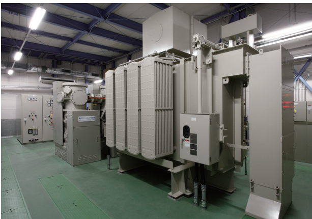
図 3 66kV受変電設備 20128
