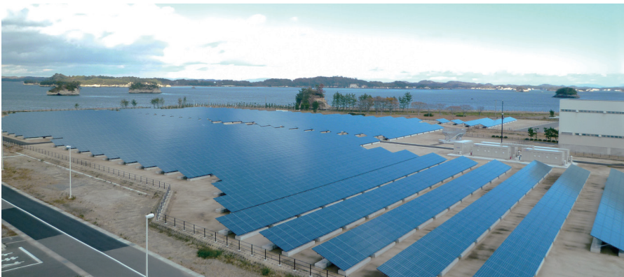
図4 東北電力株式会社殿 仙台太陽光発電所全景
