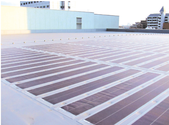
図3 太陽電池設置状況
