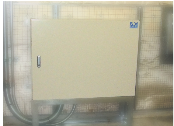
図4 ACアレイ設置状況
