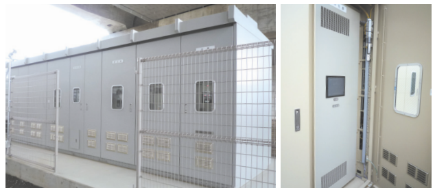
図1 屋内盤収納形屋外高低圧スイッチギヤ 図2 インテリジェント遠制御子局
