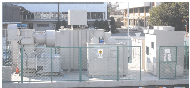
図4 66kV受変電設備
