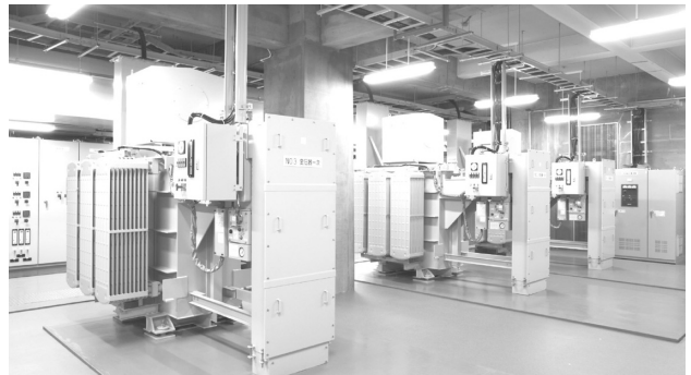
図2 スポットネットワーク用変圧器
