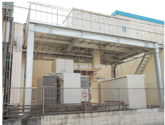
図1 22kV受変電設備
