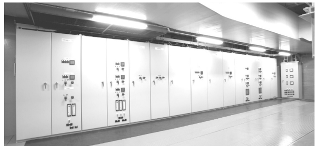
図3 7.2kVスイッチギヤ
