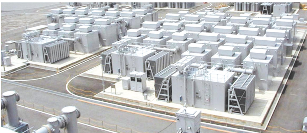
図20 大地置式 AC500kV 高調波フィルタ設備
