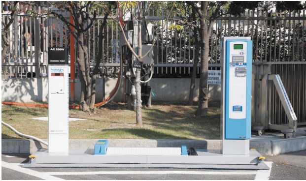
図2 充電装置設置事例
