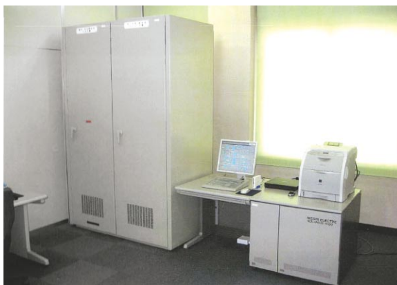
図7 リモート監視サーバ装置SUBMEX-XC
