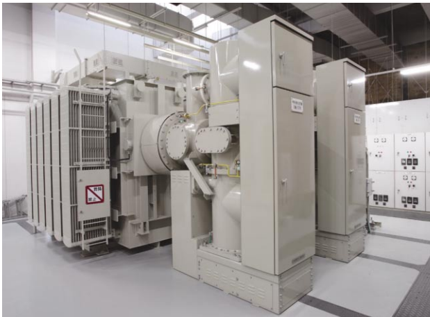
図10 66kV受変電設備（中央大学殿 多摩キャンパス）200810
