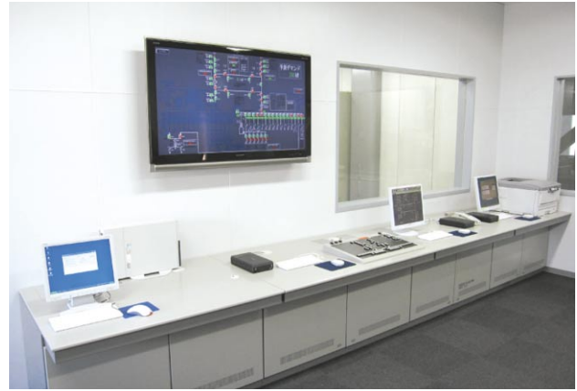
図7 中央監視制御装置
