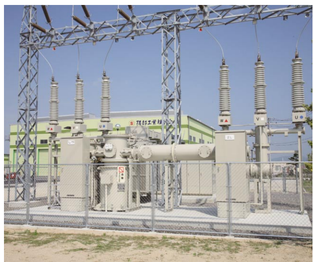
図12 77kV 受変電設備（阪部工業株式会社殿 上矢田工場） 20083
