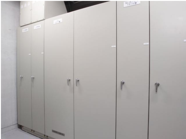
図4 22kV 受変電設備 20074 (関西電力株式会社殿 関西電力病院)
