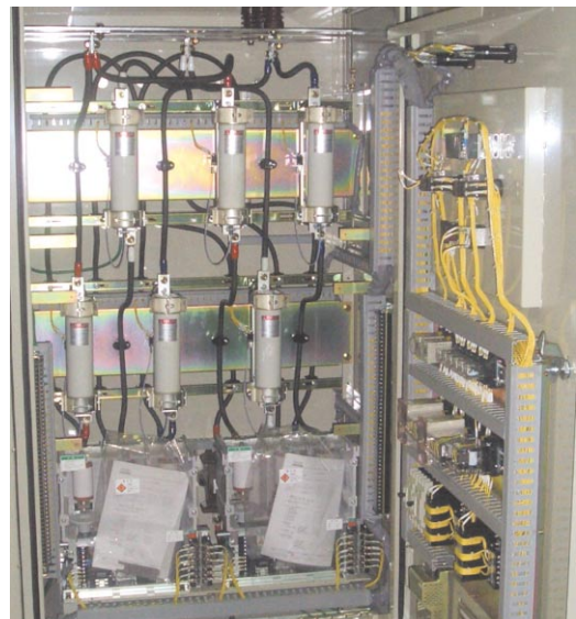
(b) 真空接触器収納箱内部状況
