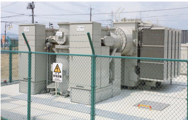
図8 66kV 受変電設備（東北ニプロ製薬株式会社殿）20085
