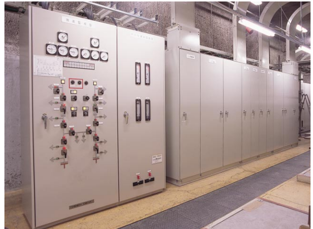
図5 22kV 受変電設備 200624 (学校法人近畿大学殿 近畿大学医学部・附属病院)
