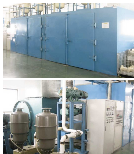
図6 乾燥炉と真空処理装置
