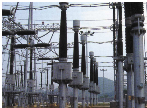
図7 日本製500kVCT運転状況
