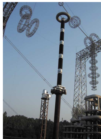
図3 UHV(1000kV) CVT実地試験
