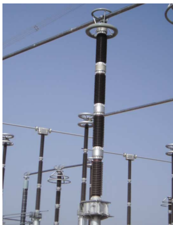
図2 750kV CVT現地据付状況
