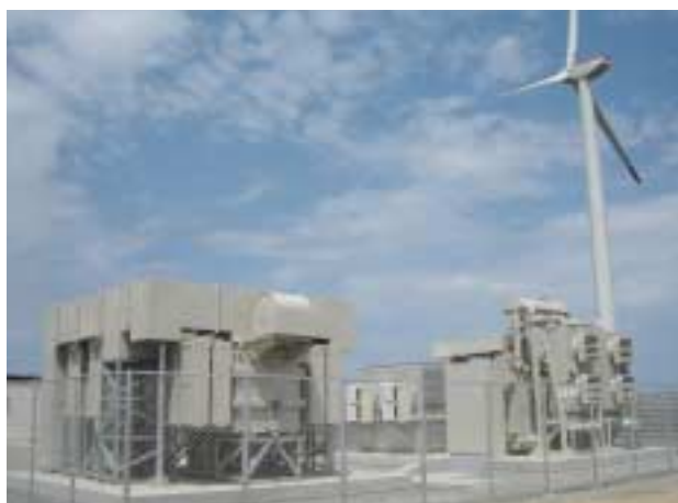
図5 株式会社ユースエナジー宗谷殿宗谷岬ウィンドファーム納め SVC
