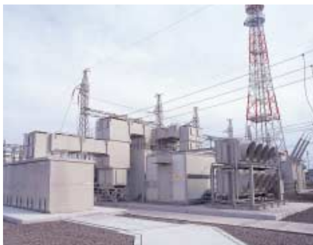
図4 東北電力株式会社殿仙台港変電所納め SVC
