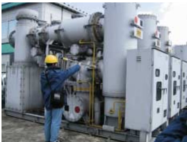
図7 GIS測定状況
